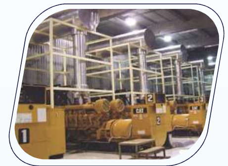
Sampoerna pandaan project 6x2000 KVA
