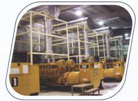
Sampoerna pandaan project 6x2000 KVA
